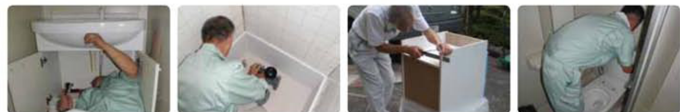
水道工事、クロス張り、木工事などいくつもの作業を1人の職人がこなしていく。施工する職人には「かゆいところに手が届く」ような、行き届いた工事の心がけが徹底しているという。また、アフターサービスも充実しており、トラブル時はいつでも駆けつける体制を整えている
